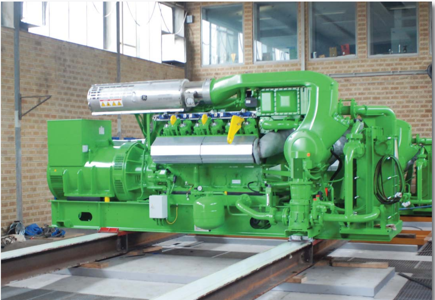
Mittels Gleitschlitten wird ein 14to schweres BHKW über die modulare Teflon-Verschubbahn zum Aufstellungsort verbracht.
