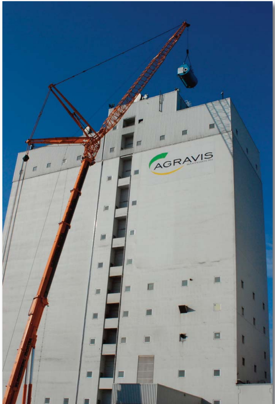
Ein 300 to Telekran mit 42m Wippspitze hebt den alten, 13 to schweren Kessel aus 66m Höhe.
